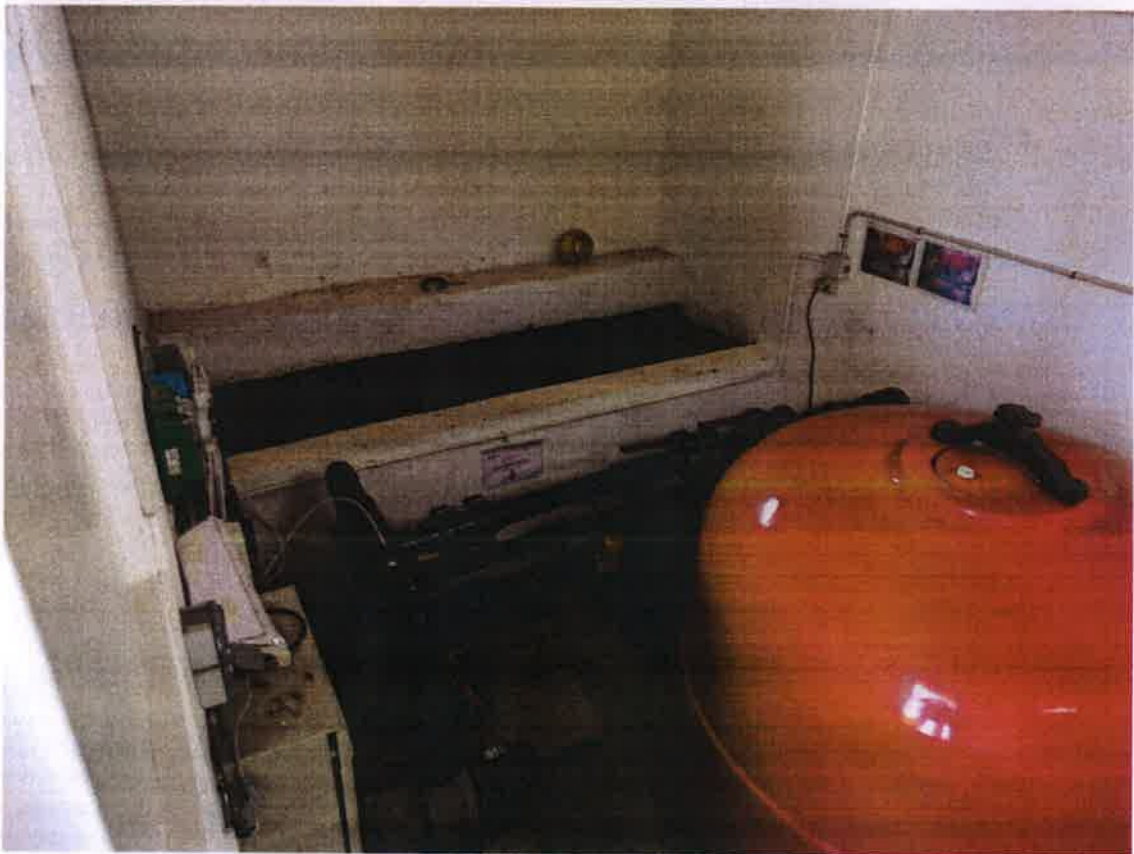
Interior de la caseta de maquinaria del vaso infantil
