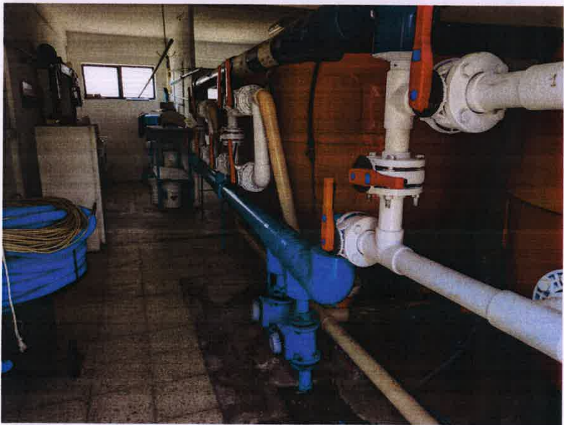
Interior de la sala de maquinaria del vaso polivalente-adultos
